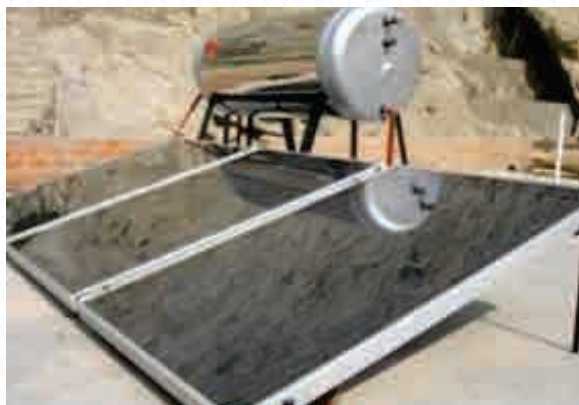
Foto 03: Sistema de calentamiento de agua para uso doméstico, mediante captadores de energía solar térmica de placa plana
